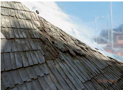
Der beschädigte Schindelschirm unter dem entfernten bisherigen Ziegeldach.
