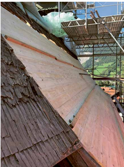
Anstelle der Schindeln wird neu eine Holzschalung und darauf die Ziegel montiert.
