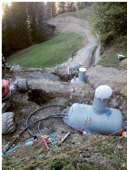
Bauwerke Brunnenstube (vorne) und UV-Anlage (hinten).
