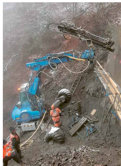
Die Sanierung des unterspülten Fundamentes der Brunnenmadstrasse wurde von der Gasser Felstechnik ausgeführt.
