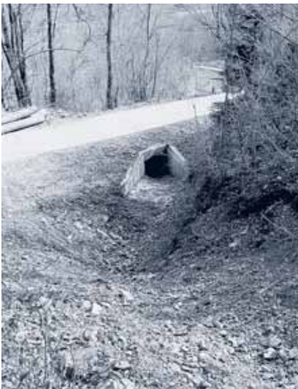
Durchleitung des Wichelsgraben unter der Schwendlenstrasse vor der Sanierung.
