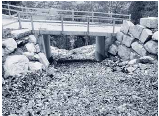
Durchleitung Schwendlenstrasse nach dem Unwetter, 1. Juli 2008.
