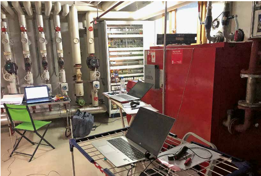
Gleich mehrere Laptops waren während der Inbetriebnahme des Anschlusses an den Wärmeverbund im Einsatz.
