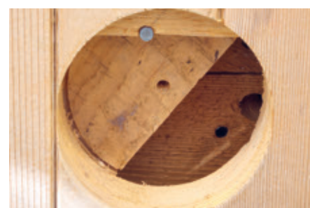
Keine Schall- und Wärmedämmung
