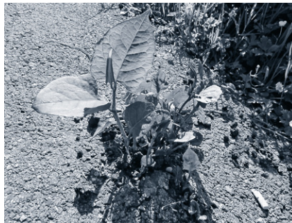
Infrastrukturschäden: Japanknöterich sprengt Asphalt.
