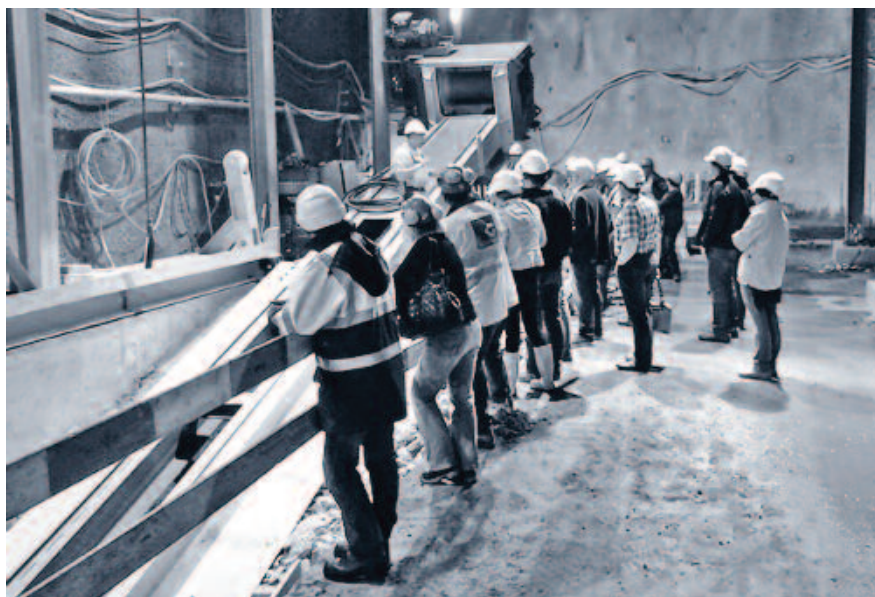
Apparatekammer mit Vorrichtung zur Montage der Druckleitungsrohre.
