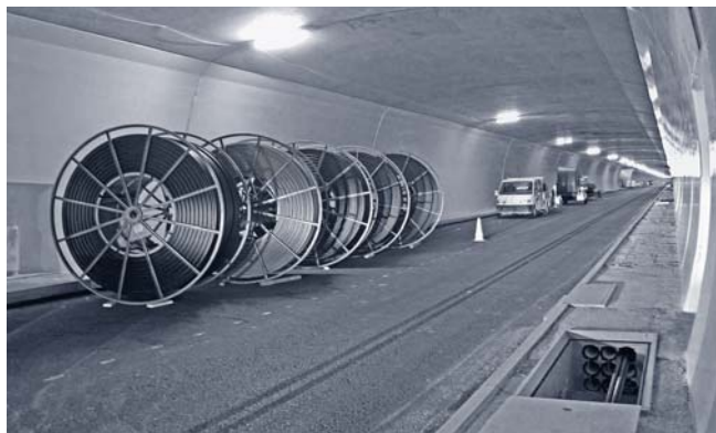
Verkabelungen im Haupttunnel.
