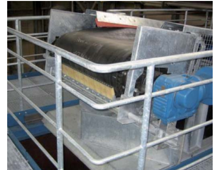
Um die Förderbänder richtig zu schmieren, muss ein Laufsteg mit einem Podest und Geländer montiert werden.
