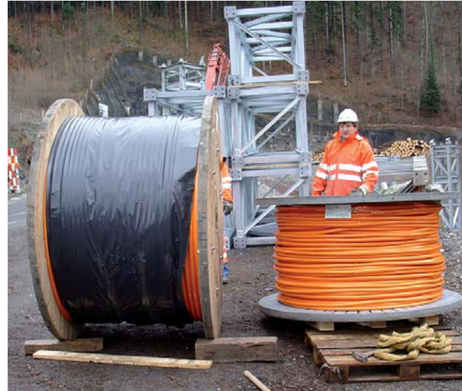
Die orangen Elektrokabel sind für den Antrieb auf der Deponie Hinti verantwortlich.
