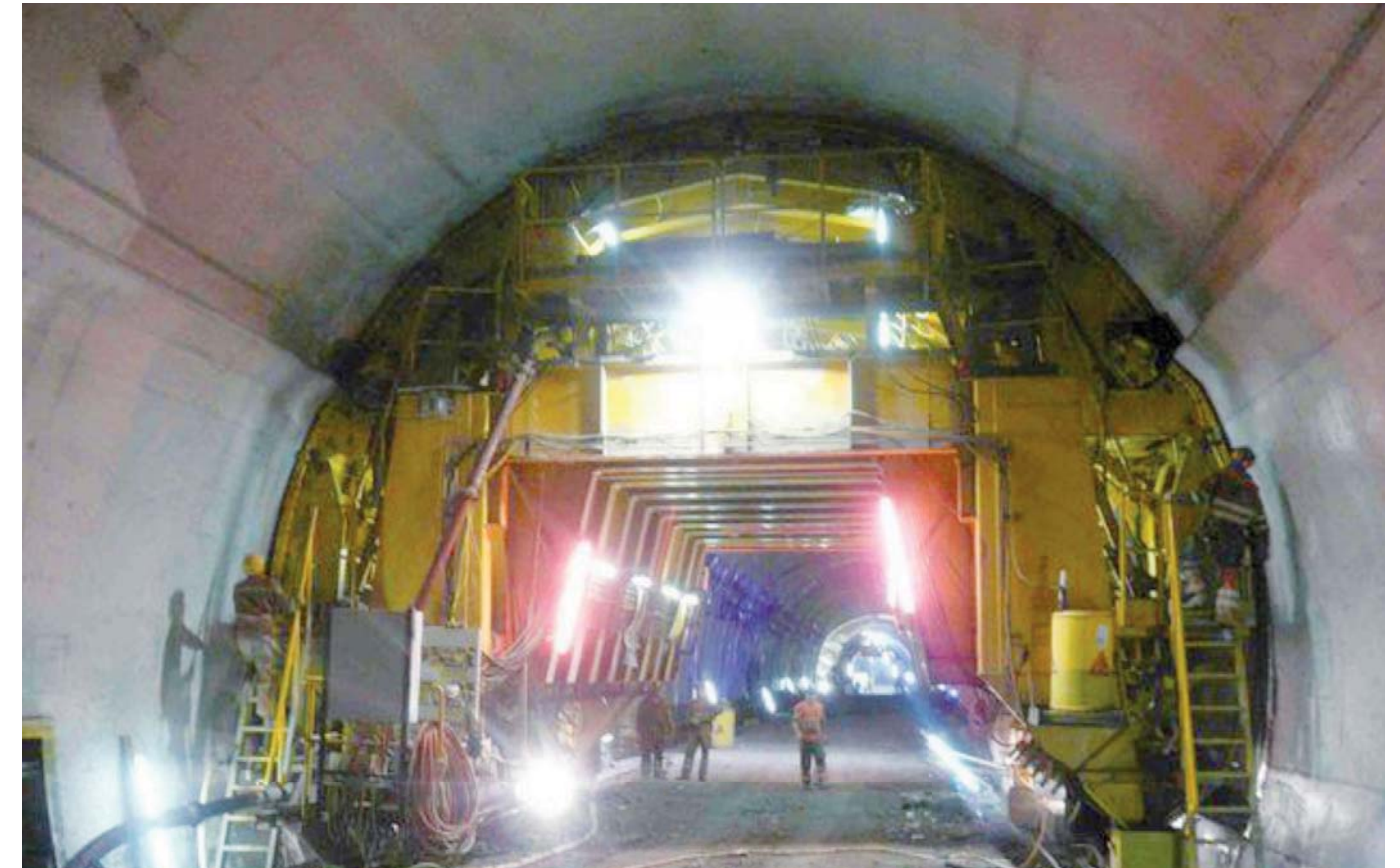
Im Tunnel werden weiterhin mit speziellen Anlagen geschalt, betoniert und abgedichtet. So bleibt nach dem Durchschlag noch viel zu tun, bis die Fahrbahn im Tunnel fertig gebaut ist.
