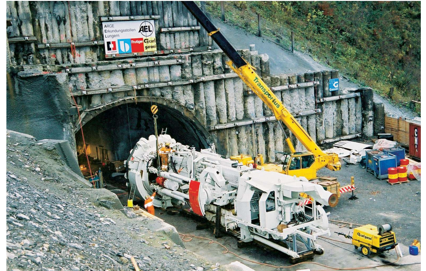
Die Tunnelbohrmaschine (TBM) wird auf Rollen auf der Nordseite des Tunnels in Position gebracht.
