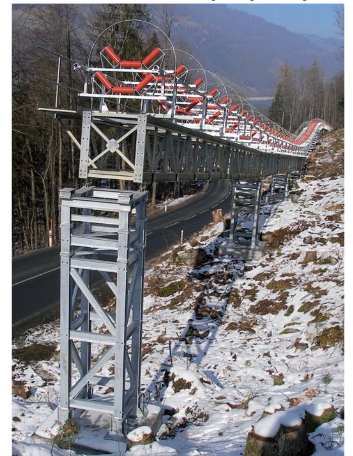
Die senkrechtstehenden Förderbandstützen tragen die ganze Bandkonstruktion. Diese erstreckt sich wellenförmig entlang der Brünigstrasse.
