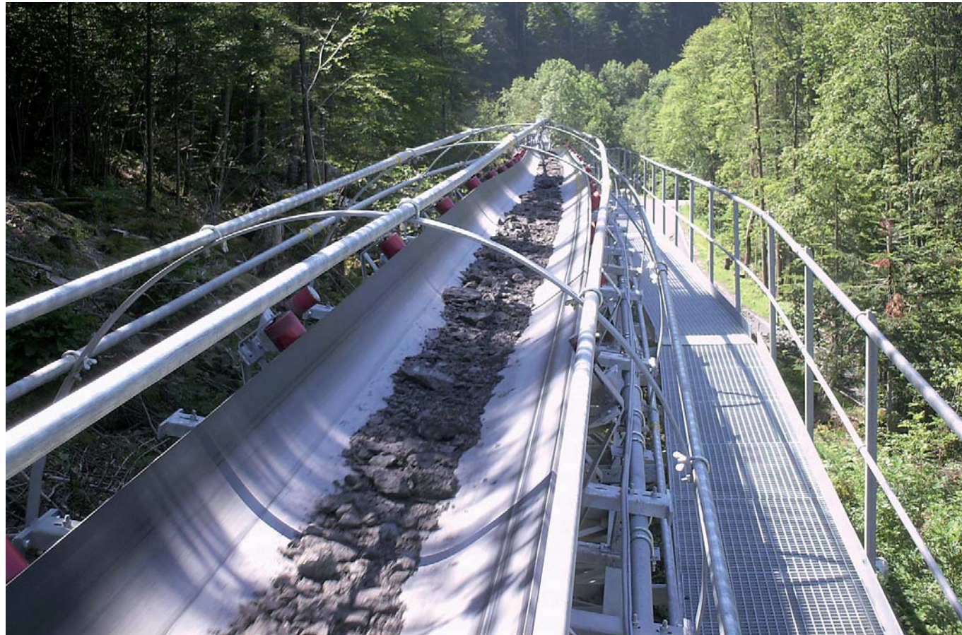
Vor Inbetriebnahme ist ein Testlauf notwendig. Und so sieht ein funktionierender Gurtenlauf aus, wenn der Gurt fachmännisch, zentrisch ausgerichtet ist.
