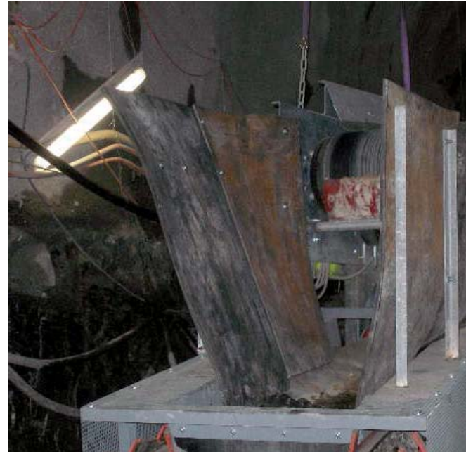
Das Brecheraustrageband bringt das Material vom Haupttunnel über das Querband im Querschlag in den Sicherheitsstollen.
