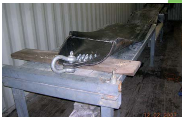
Eine Vulkanisation wird im Spezial-Container beim Portal erledigt, die zweite Vulkanisation erfolgt ca. 600 Meter weiter im Stollen auf einem speziell eingerichteten Arbeitsplatz. Dazu muss auch genügend Strom und Licht zugeführt und installiert werden.
