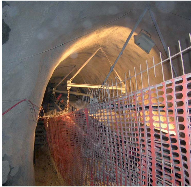
Das Förderband wird auf der Durchgangsseite mit einem Netz gesichert. So können die Betriebsmitarbeiter sicher neben der Förderbandanlage gehen.
