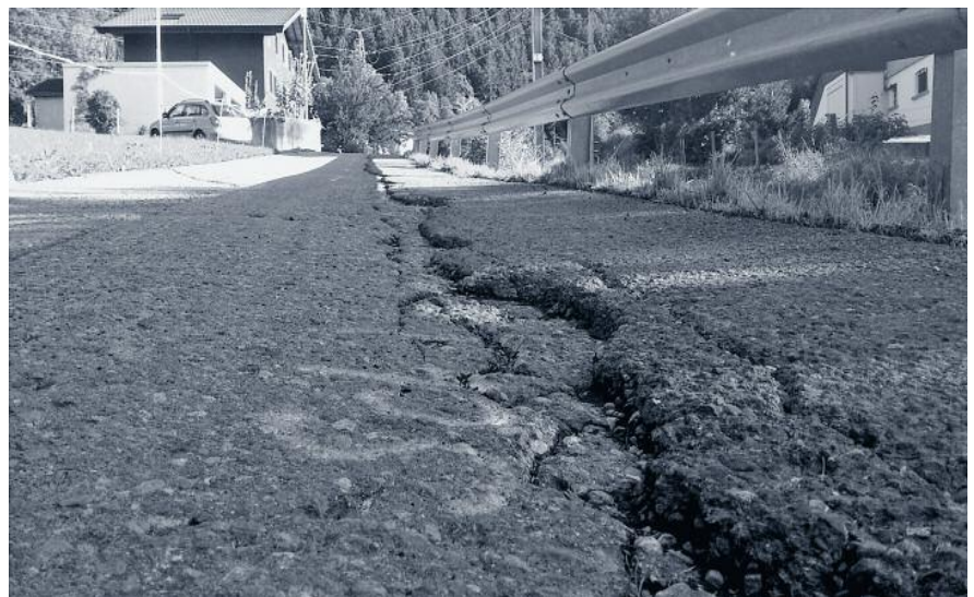
Der Asphaltbelag vom Chäppelisträssli befand sich in einem schlechten Zustand und musste erneuert werden.
