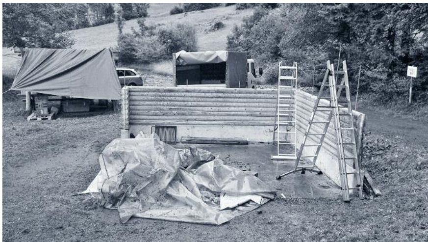
Die Grillstelle in der Aglimatt musste wegen des Ausbaus vom Geschiebesammler abgebrochen werden. Sie wird aber im nächsten Jahr wieder aufgebaut.
